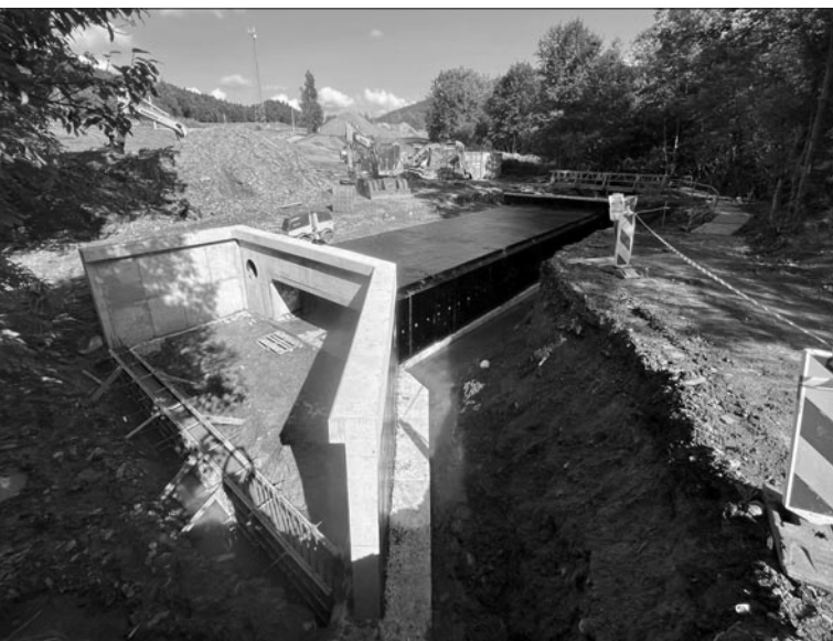
Jeden z przepustów w ciągu powstającej drogi Szymony – Gruszowiec w Kasinie Wielkiej
